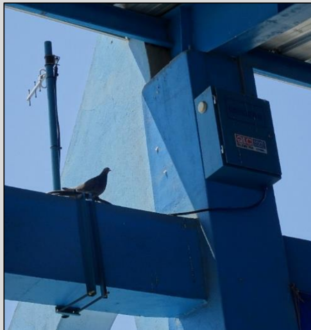
ANTENA RF. EN EDIFICIO DEL MERCADO
