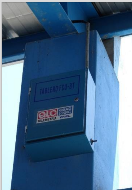
COLECTOR DE DATOS PLC EN BAJA TENSION –EDIFICIO DEL MERCADO
