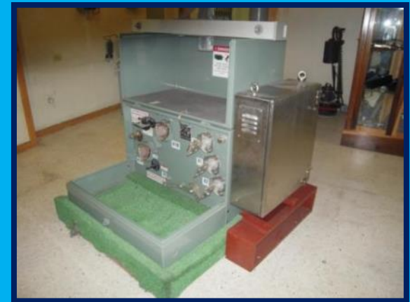
ENERGY GUARD ACOPLADO A TRANSFORMADOR PADMOUNTED
